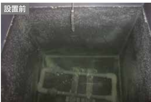
※配管洗浄から1週間後
